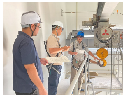
天井クレーン月次自主点検の様子
